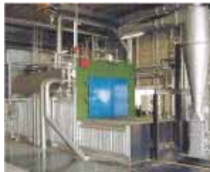
写真 木紛・木屑ボイラー
