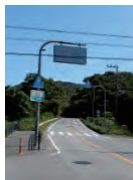
<老朽化した道路標識>
