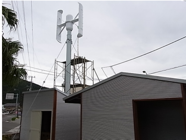
図表 4-2-7：建設業と地域の元気回復助成事業で建設した風車
